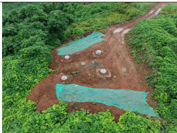
自贡 II~黄市 NB29 塔塔基临时占地机械碾压区域、新修汽运道路未铺设钢板，临时堆土、裸露地面苫盖不到位
