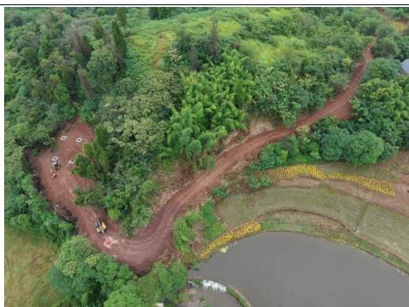
自贡 II~黄市 NA36 塔表土剥离保护不到位，塔基、新修汽运道路未设临时排水沟、沉沙池，道路挖填坡面未苫盖
