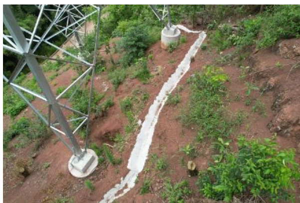
塔基区截排水设施
